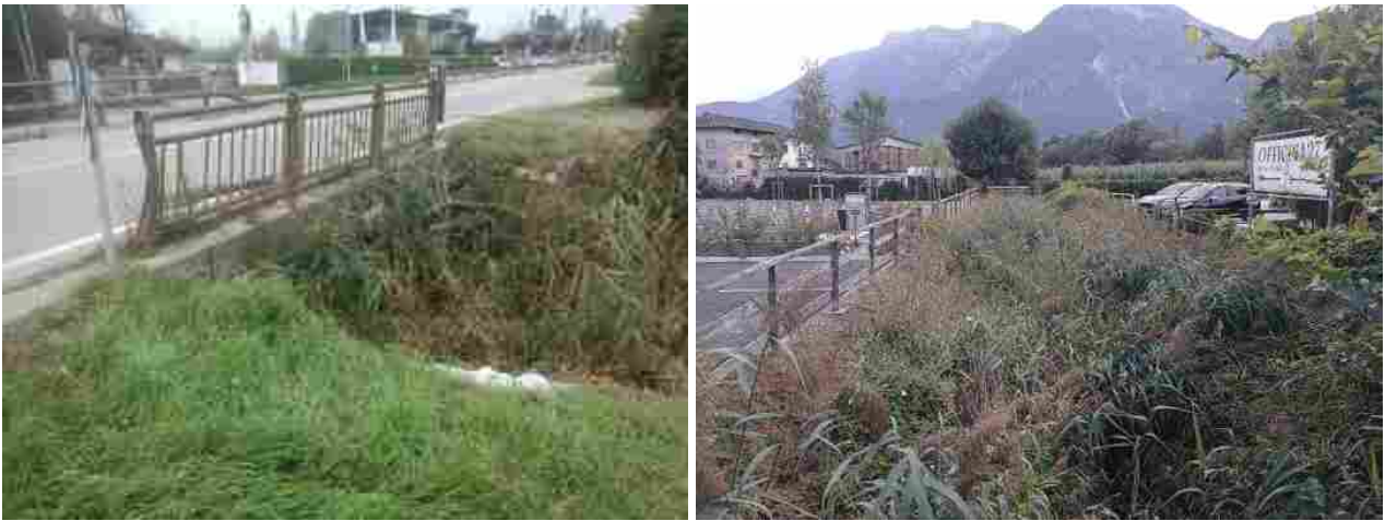
Fig. 2.16 – 2.17 - Sezione di attraversamento della SP1 e tratto a valle della viabilità. La presenza di vegetazione invasiva risulta molto elevata a parzializzare le sezioni idrauliche.
