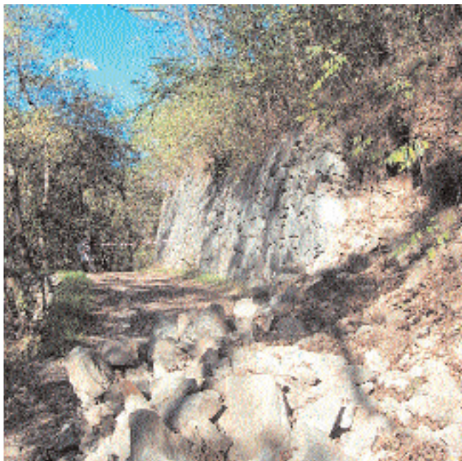
Strada Col delle Benne prima degli interventi
